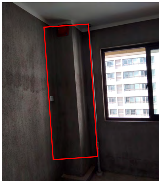
住宅楼油烟通道
