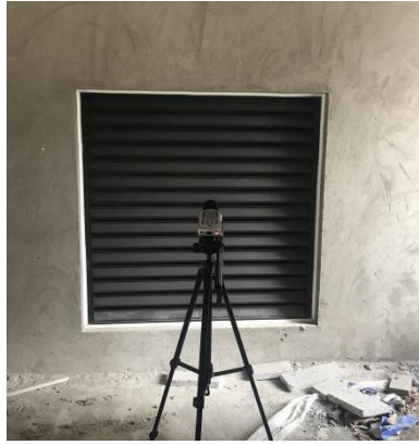
地下车库排风口 1#
