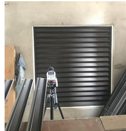
地下车库排风口 2#
