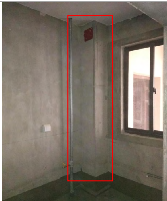
住宅楼厨房烟道及止逆阀
