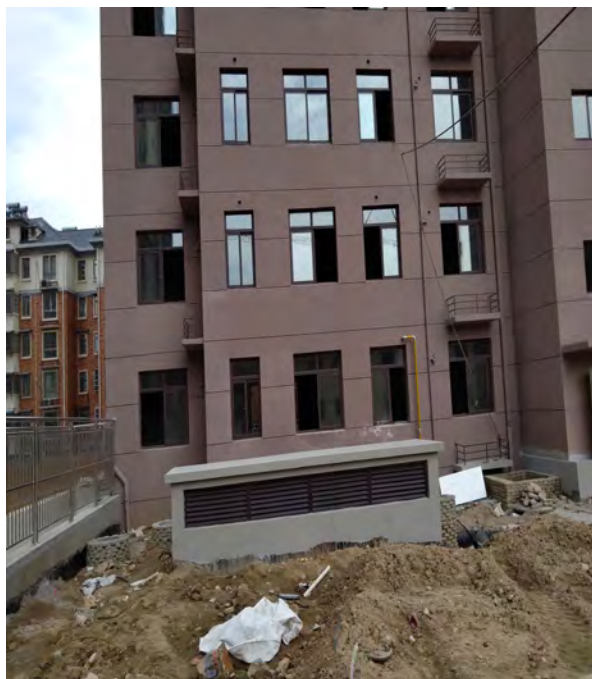
地下车库排风口
