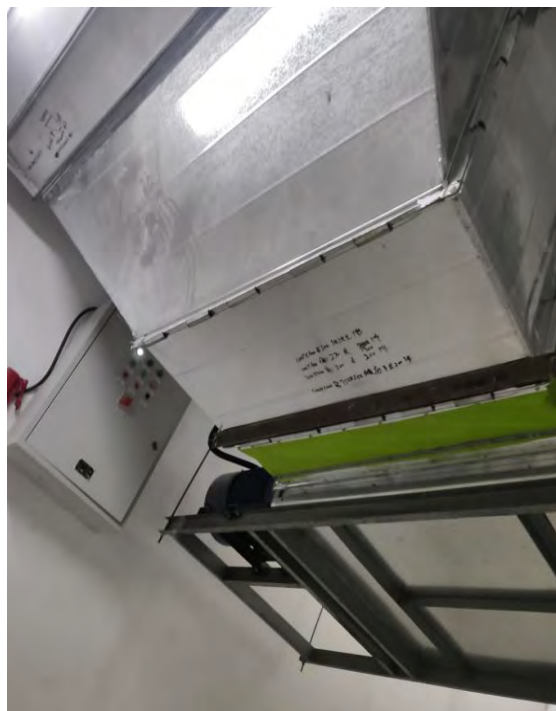
地下车库排风风管
