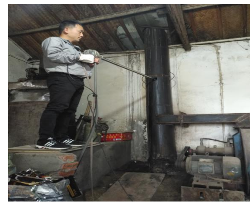
锅炉烟气排口
