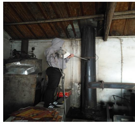
锅炉烟气排口
