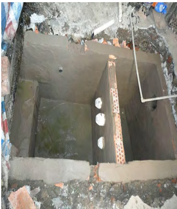
幼儿园食堂隔油池
