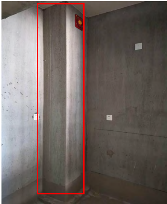
住宅楼厨房烟道及止逆阀
