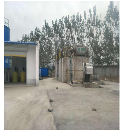
污水处理设施
