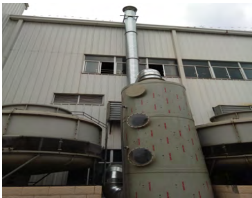
有机废气处理设施
