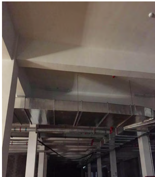
地下车库排风管道
