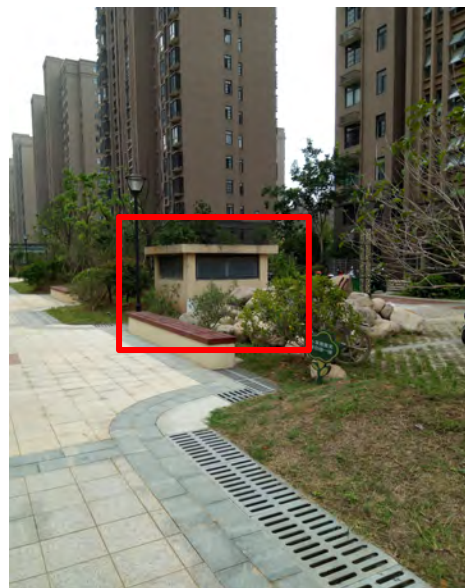
地下车库排风口
