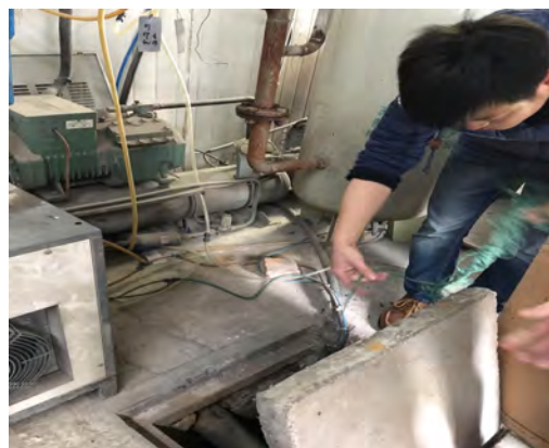
生活污水排口
