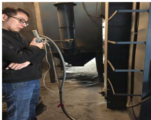
抛丸废气排气筒进口
