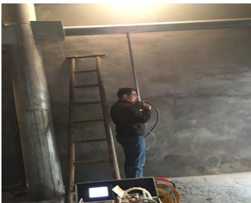
打磨废气排气筒出口
