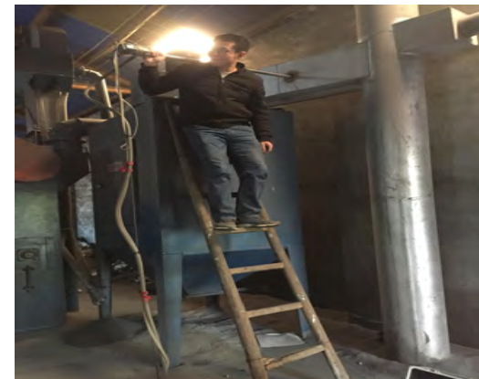
抛丸废气排气筒出口
