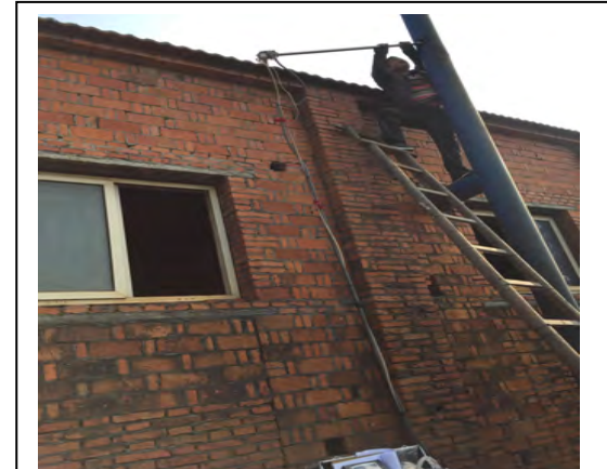
抛丸废气排气筒出口
