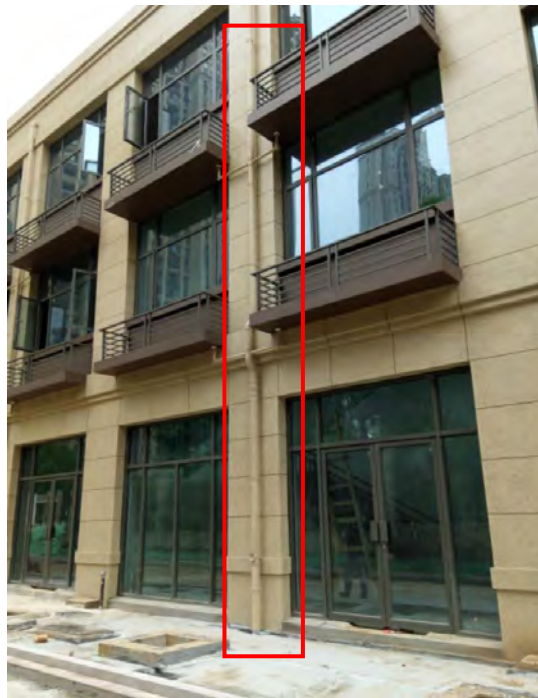
商业区雨水管道
