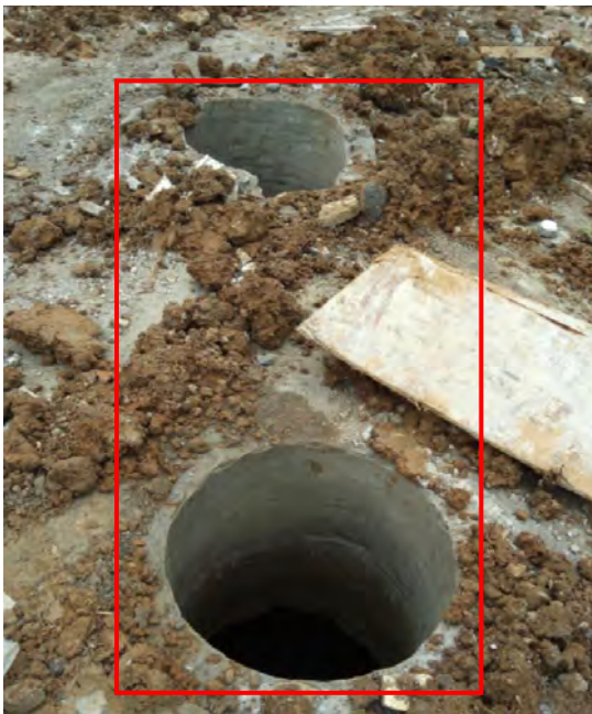
S01、S02 南侧化粪池和隔油池
