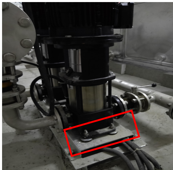
生活水泵房减振垫片
