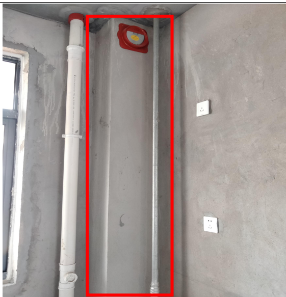
住宅楼专用烟道和止逆阀
