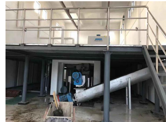
污泥脱水装置
